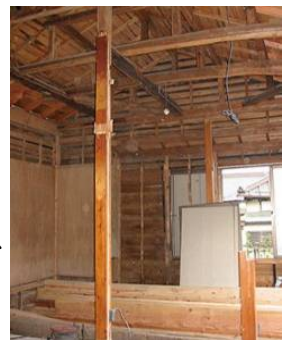
断熱材が入ってない建物はスケルトンリフォームが必要になります
